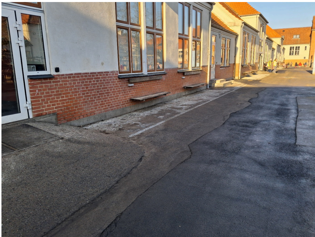
Skolegården på Valdemarskolen er efter opgravning lappet med asfalt i felter.
