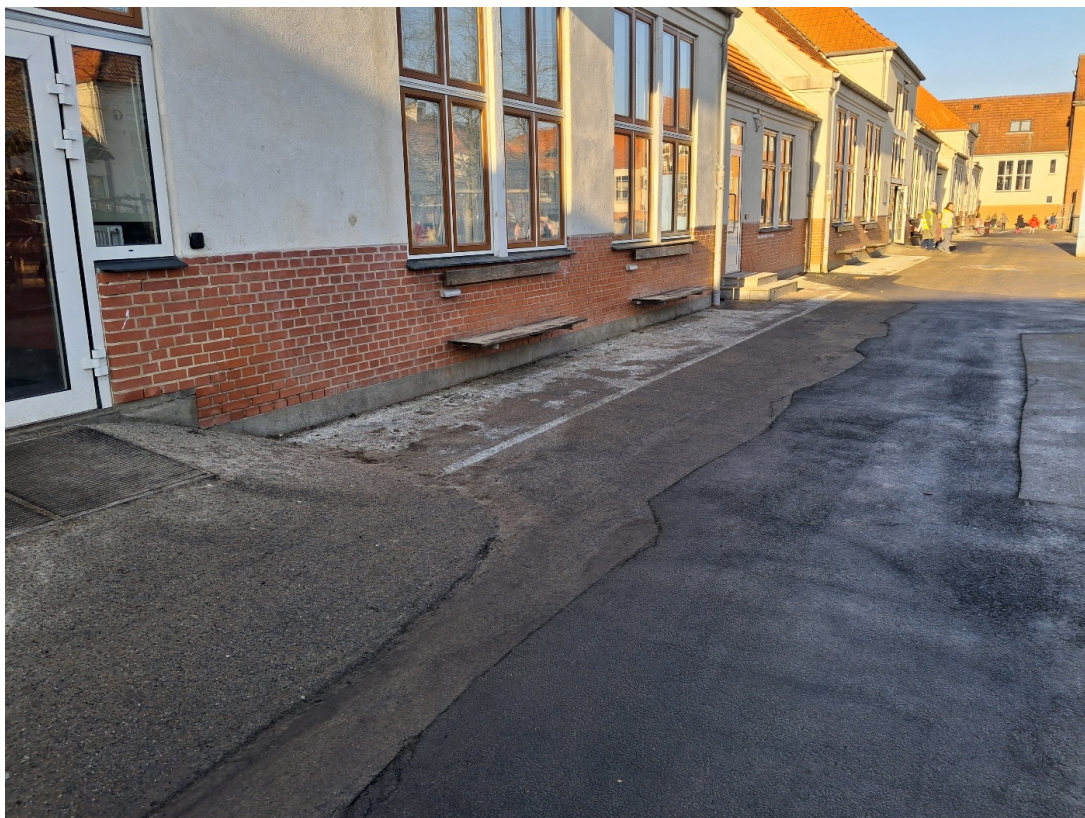
Skolegården på Valdemarksskolen er efter opgravning lappet med asfalt i felter.
